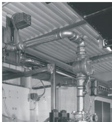
Przewody elastyczne ES zamocowane na liniach zasilających
